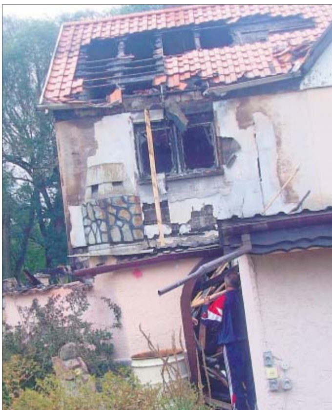
Vom Schuppen griffen die Flammen aufs Haus über. Das Dach musste die Feuerwehr aufbrechen, um die immer wieder auflodernden Glutnester zu löschen. Foto: Beer
