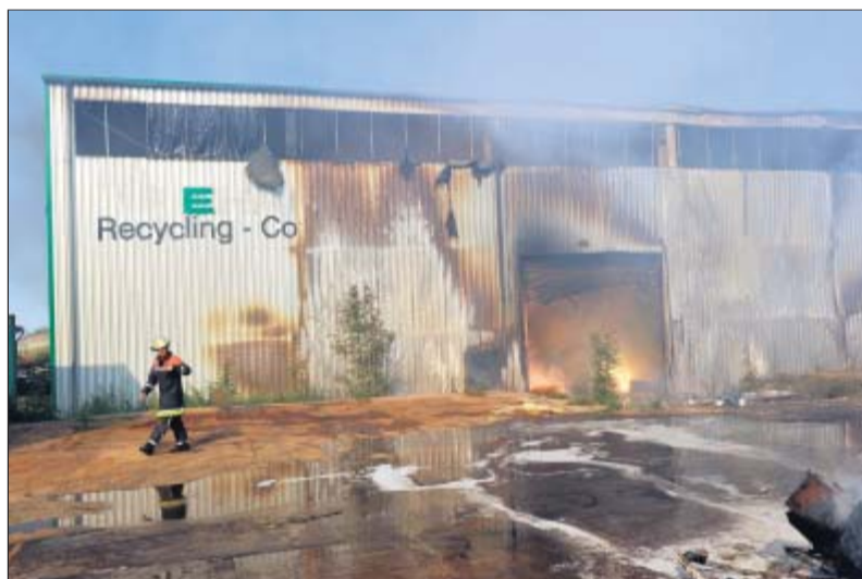
Die enorme Hitze beschädigte die Stahlkonstruktion der Halle. Fotos: camera900.de
